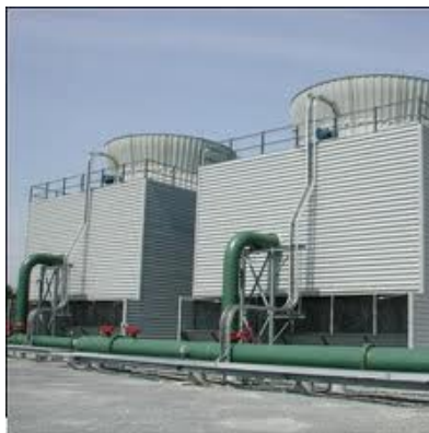
Figura 18 – Torres de Arrefecimento com tanques de condensados
